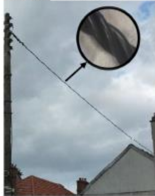
Réseau fils isolés aérien BT
