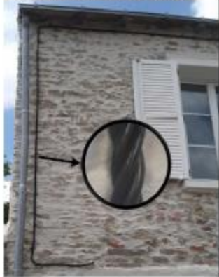
Réseau fils isolés façade BT
